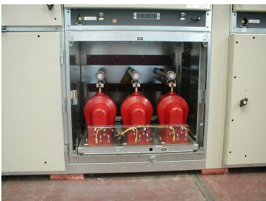
Cella TV in posizione di sezionato. VT cubicle in disconnected position.
